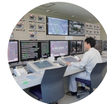
操作室 穀物の搬入・保管・搬出の全行程をコンピュータで制御します。
