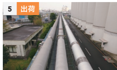
5 出荷 コンベア お客様の工場へ直接繋がれたコンベアで穀物を出荷します。
